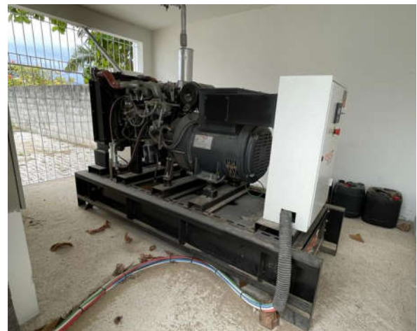
GERADOR DE ENERGIA
